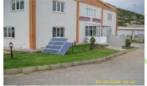
SDÜ YEKARUM hizmet binası önünde çalışmakta olan çevre aydınlatma Üniteleri.
