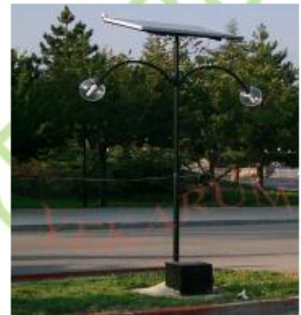
Batı yerleşke Rektörlük Bölgesinde çalışmakta olan çevre aydınlatma Üniteleri.
