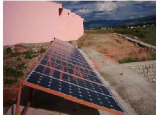
SDÜ YEKARUM Temiz Enerji Dvi PV Sistemi.
